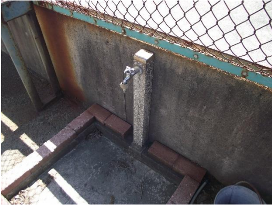
バックネット裏 水道
