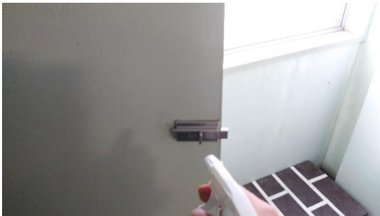
扉の内側の錠となる部分
