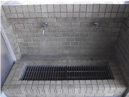
職員玄関 水道
