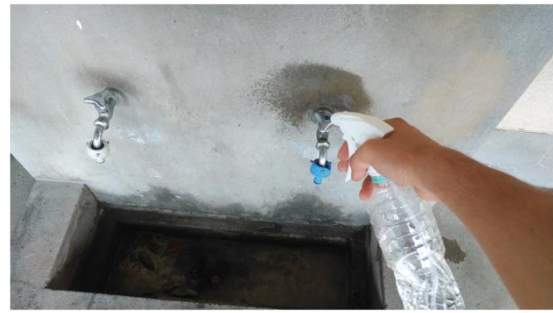
体育館前 水道
