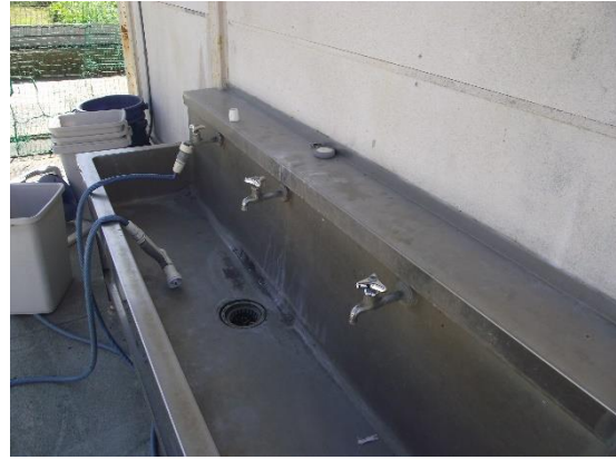
部室棟側 水道
